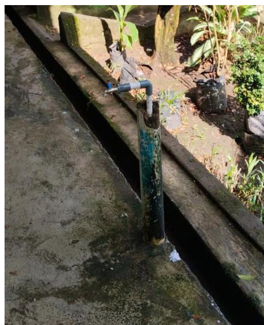
Penyediaan Kran Untuk Cuci Tangan
