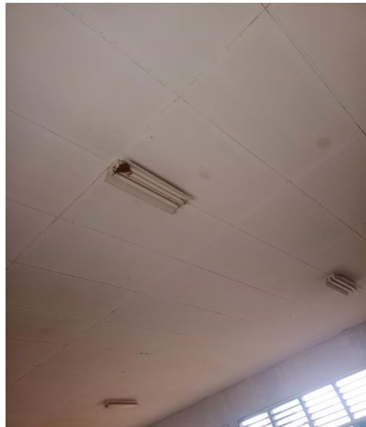
Gambar 11. Kondisi lampu dalam ruangan
